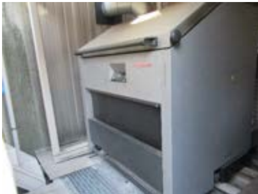
写真 ドイツ製薪ボイラー1基が稼働している。もともと使用していた灯油ボイラーも稼働しており、薪ボイラーがメインではなさそうである。
