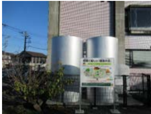
写真 貯湯タンクと薪エネルギーの利用システムの解説板
