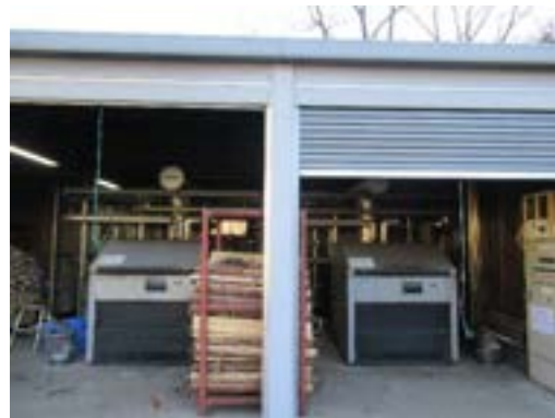
写真 ボイラー建屋には2基の外国製薪ボイラーが配置されている。
