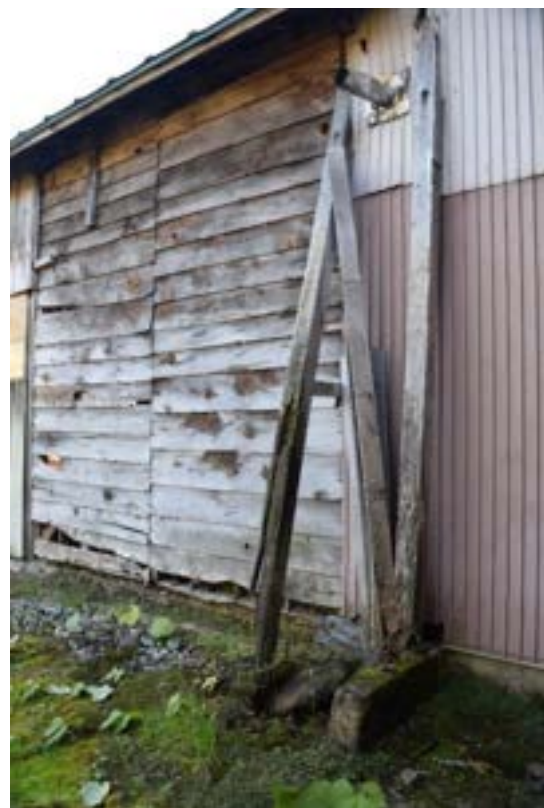
写真 8 北側方杖腐食状況
