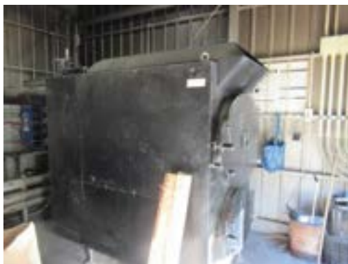
写真 元湯は国産のガスファイヤー1基のみである。
