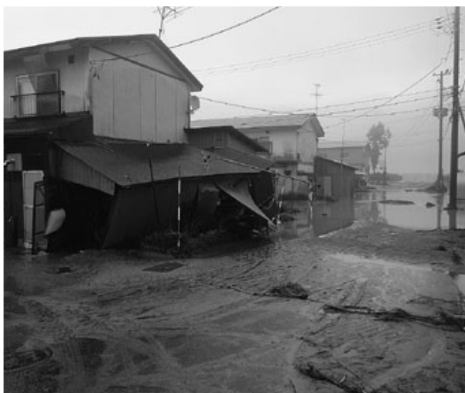
豪雨災害による住宅の被災状況
