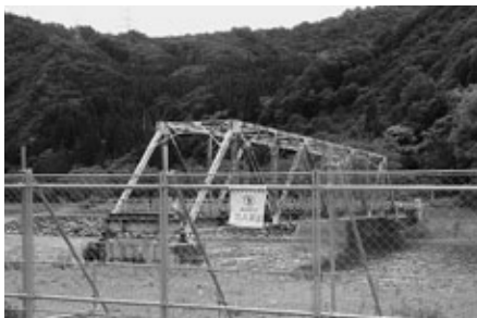
落橋したままの萬代橋
