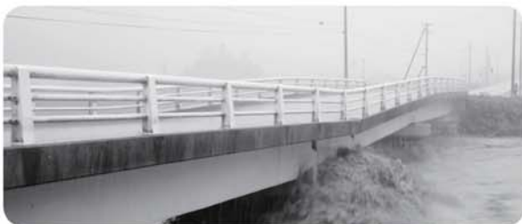
豪雨による河川の反乱で国道の橋が曲がり、交通に支障をきたした。
