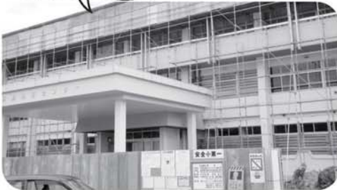
『現在、只見地区センターは、施設のアスベストを除去しています。』
