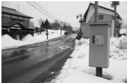
福井にある消雪パイプの操作盤
