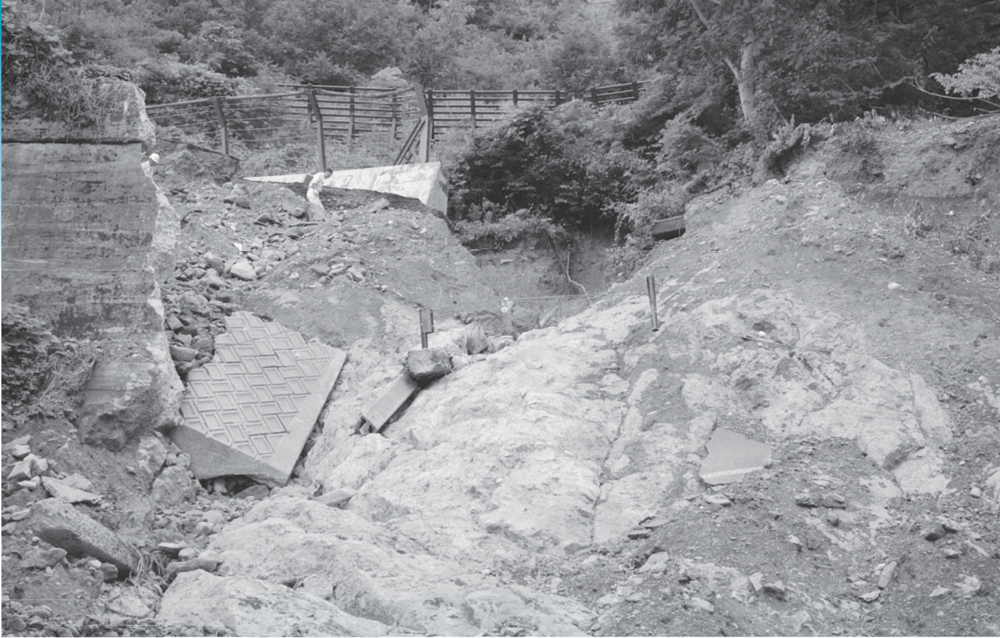
約50メートル崩落し通行できない国道252号(石伏地内)
