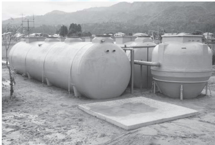
小川地区に設置された合併浄化槽
