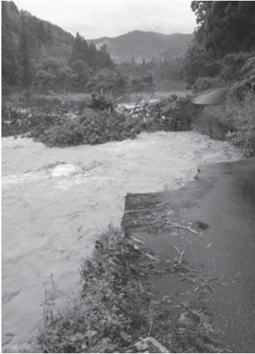
▲流失した林道
