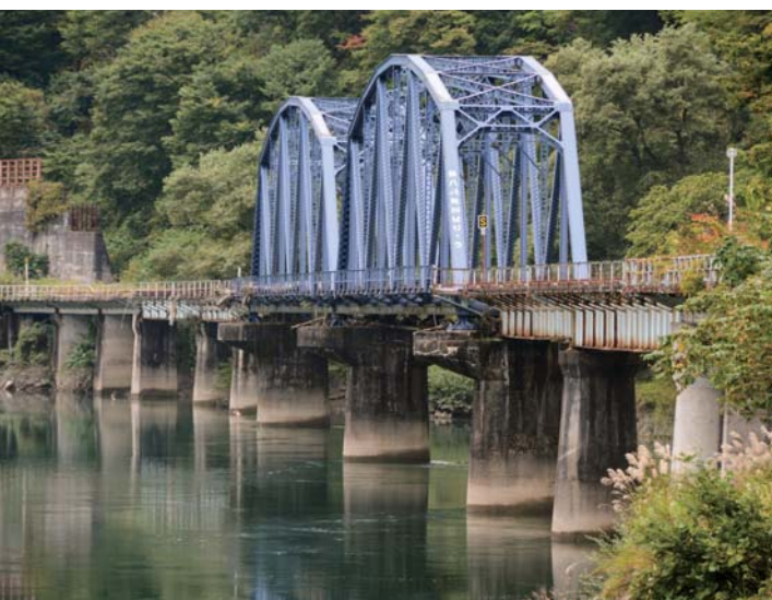
▲第8只見川橋梁(只見町)【冠水や流木の堆積】
