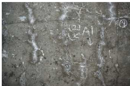
162. 宮沢橋：RC床版橋 (橋長：4.45m、1983年竣工) 床版下面の遊離石灰を伴う二方向ひびわれ ※多数のひびわれの発生により、耐荷力の低下が推測される。(迂回路有り)
