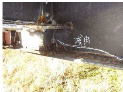
14. 町下橋：鋼トラス橋+鋼I桁橋 (橋長：3.30m、1965年竣工) 横桁下フランジの板厚減少 ※腐食の進行による板厚減少により、耐荷力の低下が推測される。(迂回路有り)
