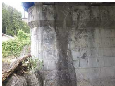
12. 辰目沢橋：RCT桁橋 (橋長：21.10m、1978年竣工) 橋台及び橋脚の遊離石灰を伴うひびわれ ※雨水の浸入により、進行する可能性が高い。(迂回路無し)
