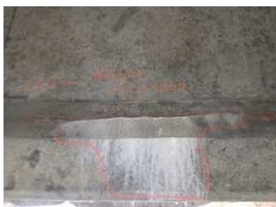
18. 熊倉橋：ポステンT桁橋 (橋長：178.20m、1977年竣工) ポステン桁下面のひびわれ、遊離石灰 ※雨水の浸入により、内部鋼材の腐食が進行する可能性が高い。(迂回路有り)
