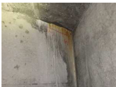
5. 白沢橋：ポステンT桁橋 (橋長：35.80m、1977年竣工) 端横桁の錆汁を伴う遊離石灰 ※雨水の浸入により、内部鋼材の腐食が進行する可能性が高い。(迂回路有)
