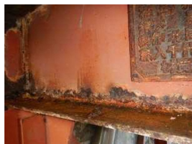
20. 不動滝橋：鋼トラス橋 (橋長：50.00m、1969年竣工) トラス上弦材の板厚減少 ※腐食の進行による板厚減少により、耐荷力の低下が推測される。(迂回路有り)
